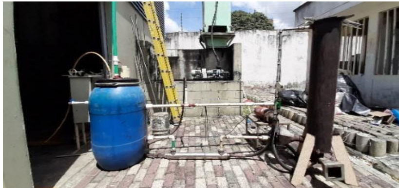
Figura 3. Projeto final e montagem do gaseificador de zonas múltiplas
